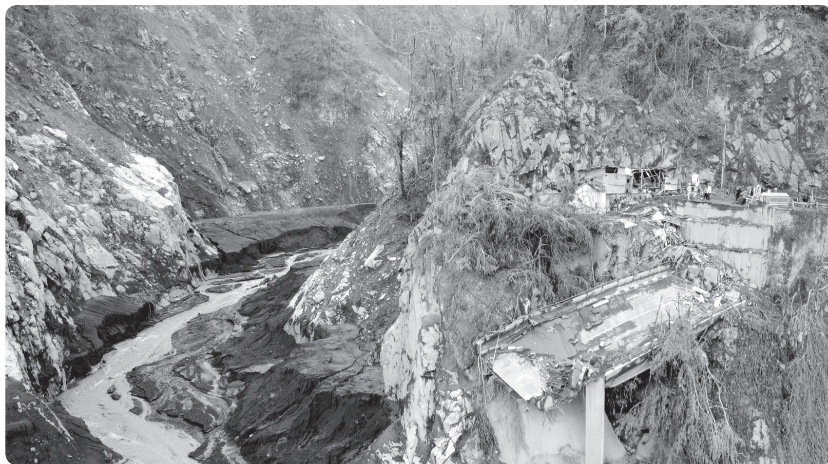
KONDISI TERPUTUSNYA GLADAK PERAK
